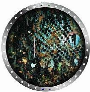
fig.7.7.Colmatarea țevelor unui schimbător dintr-o termocentrală.
